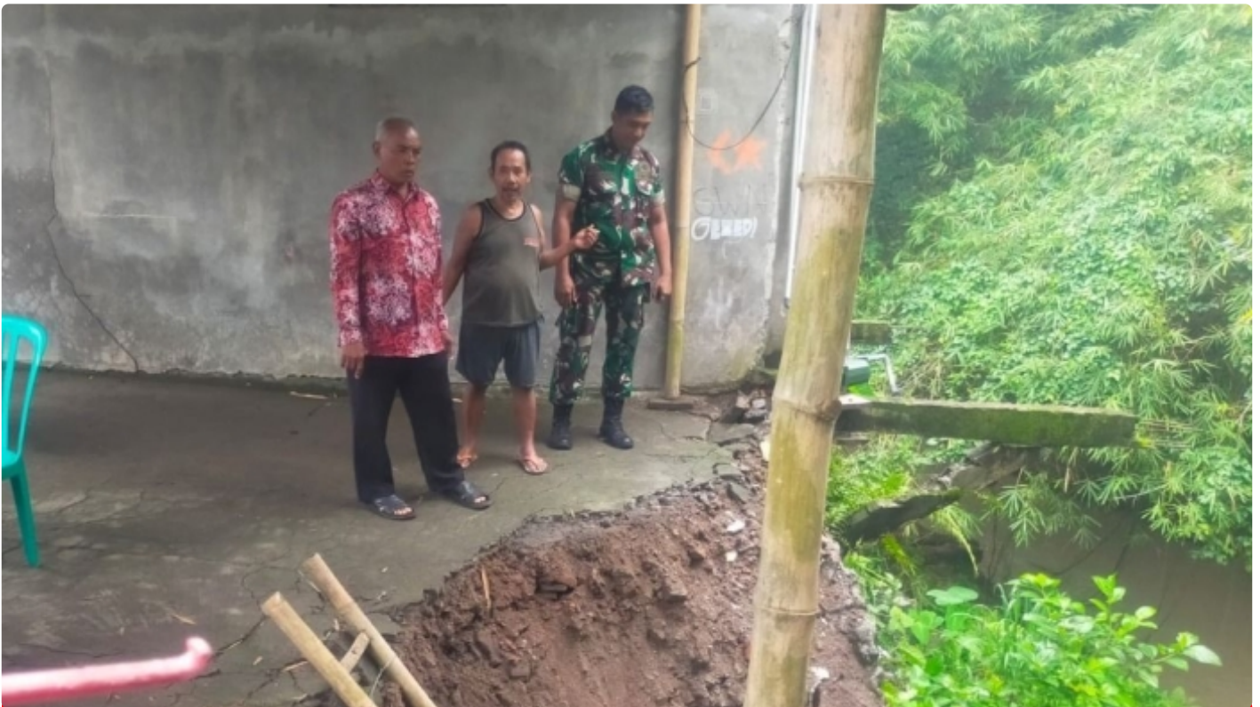
Longsor Di Desa Jambukulon Danramil 23/Ceper Bersama Muspika Tinjau Lokasi Longsor
